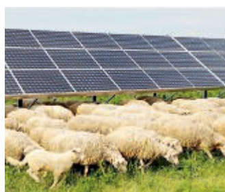
Il pratopascolo con fotovoltaico
